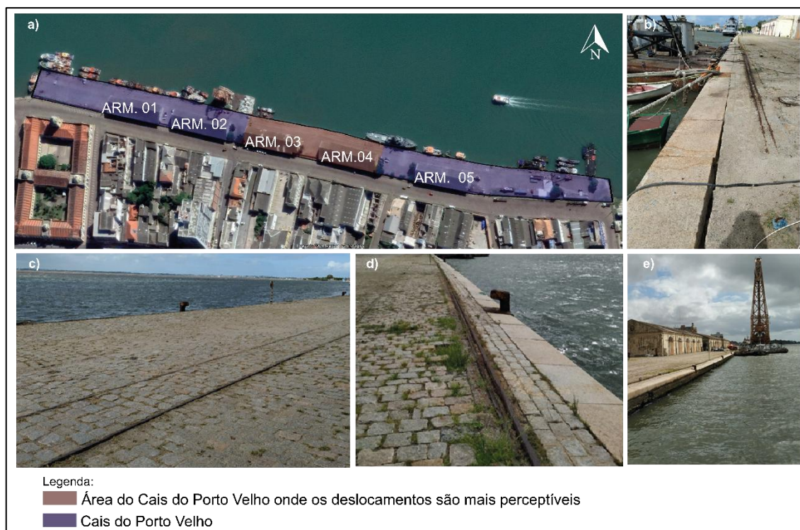
Figura 2: a) Identificação da área de estudos; b) Deslocamento dos blocos da estrutura do cais; c) Variação de altura ao longo dos paralelepípedos do pavimento e dos blocos de coroamento do muro de gravidade; d) Deslocamento do muro de gravidade em direção ao canal de navegação; e) Área onde os deslocamentos são mais intensos.
