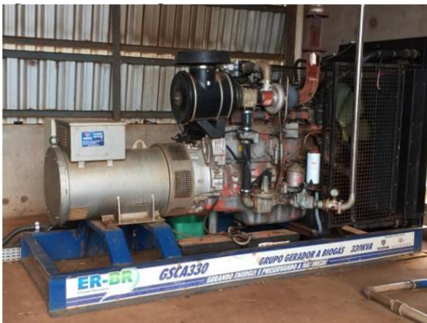
Figura 2 – Gerador de energia
