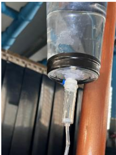
Figura 2 – Reservatório de água.
