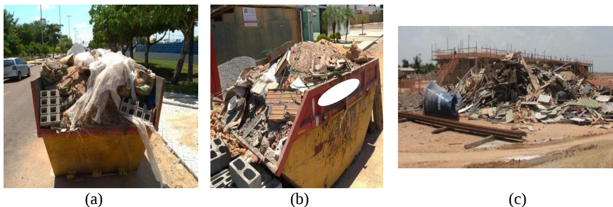
FIGURA 2 - Falta de separação dos resíduos nos canteiros de obras de Boa Vista.
