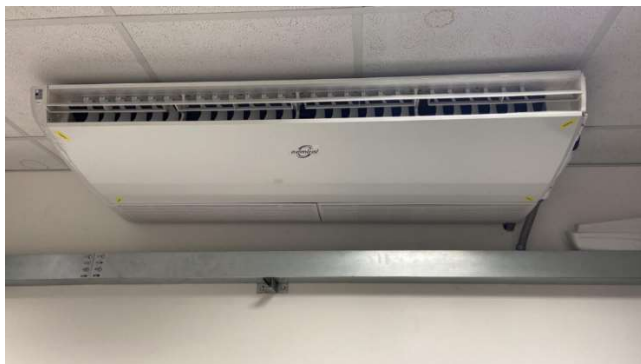
FIGURA 8. Ar condicionado 1 de potência 35.000 BTU
