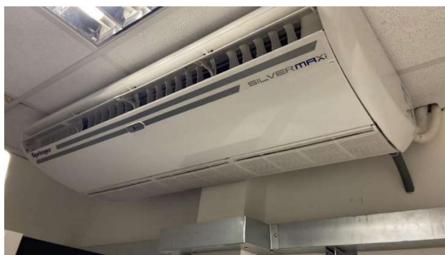
FIGURA 9. Ar condicionado 2 de potência 48.000 BTU
