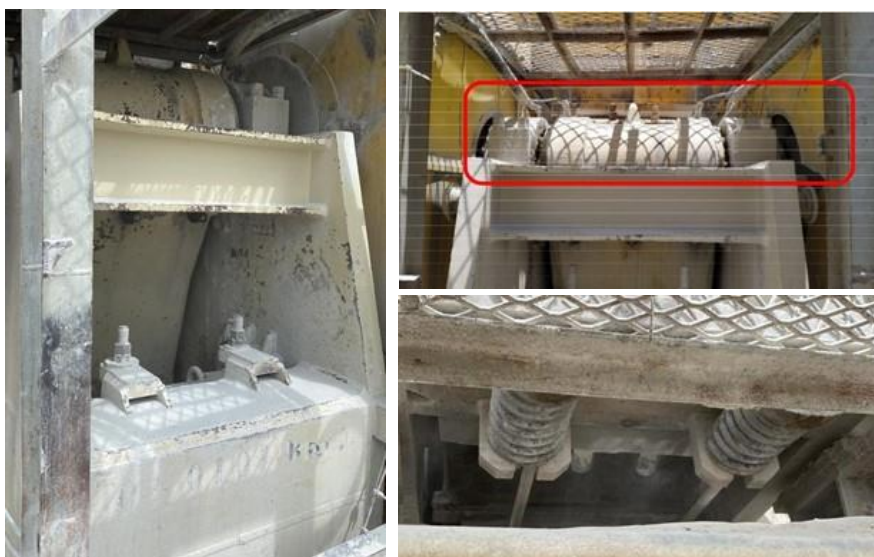
FIGURA 8. Situação inicial do Britador de Mandíbulas.
