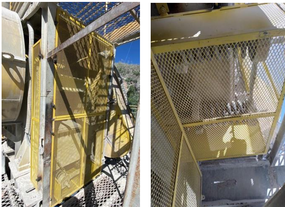
FIGURA 10. Proteção colocada no britador de mandíbulas.
