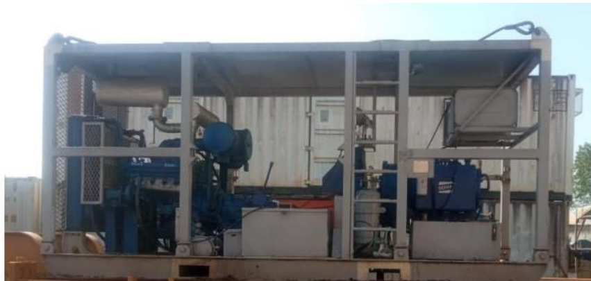
FIGURA 7: Unidade de bombeio offshore montada sobre skid.
