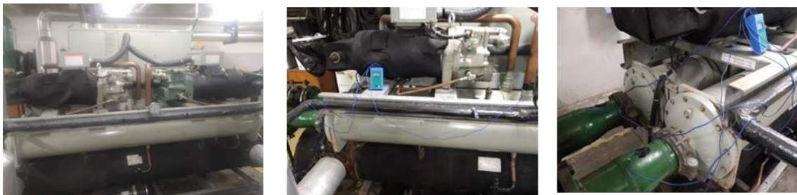
FIGURA 2. Fotos do dispositivo experimental implementado em campo, montagem da instrumentação no chiller .
