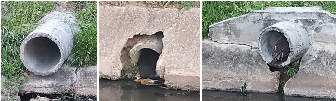
Figura 5 - Exemplos de ligações classificadas como parcialmente degradadas.
