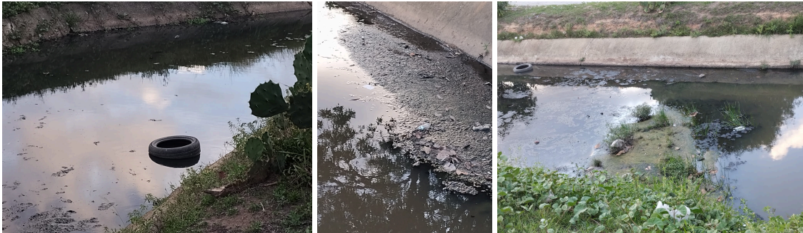
Figura 7 - Resíduos sólidos e esgotos dentro do canal
