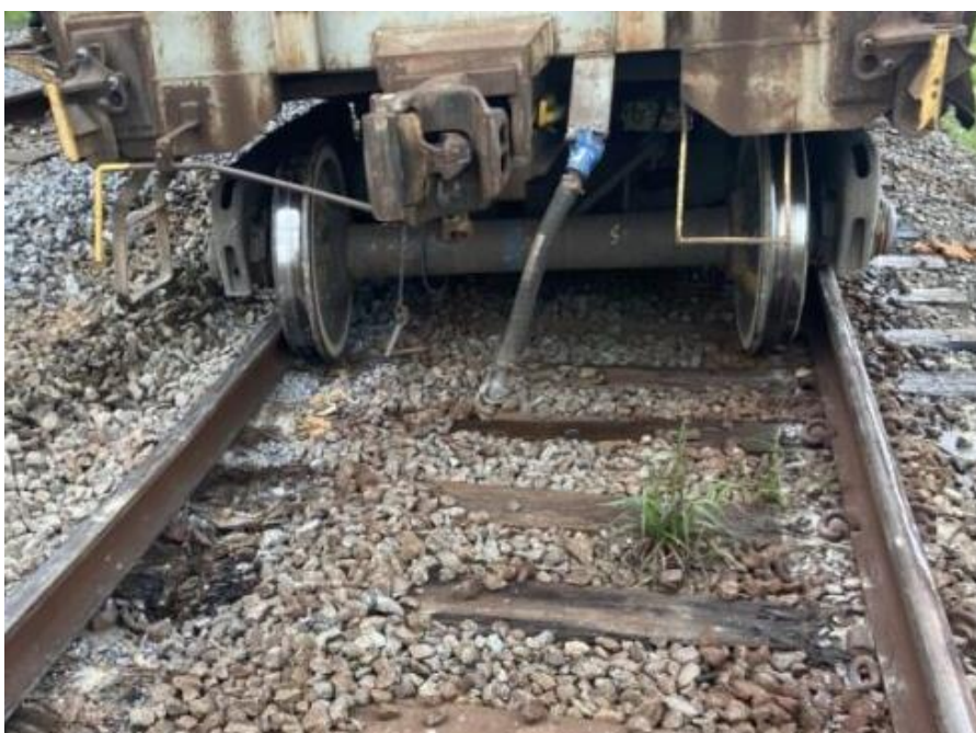
Figura 3. Descarrilamento por abertura de bitola em curva
