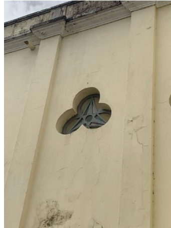
Imagem 14 - Paredes externas da igreja com pintura desgastada. Foto por Dheysiana Hadasia, 17 de março de 2023.
