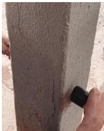
b – Pilar com trinca
