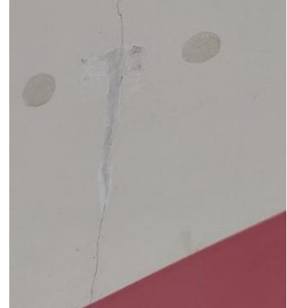
c – Parede fissurada
