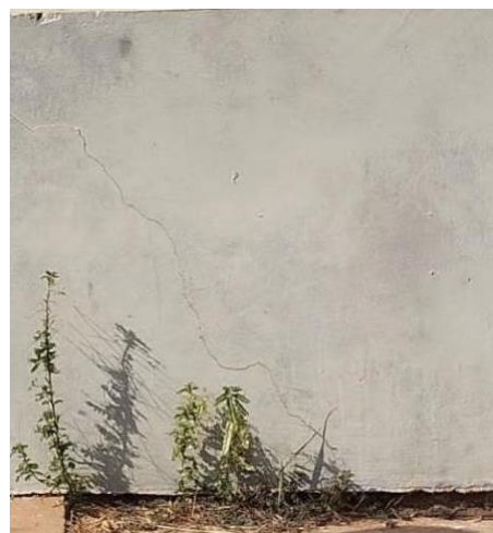
b – Possível recalque
