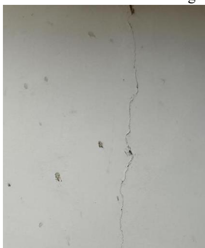
a – Fissura causada por sobrecarga
