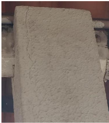
a – Pilar com fissura
