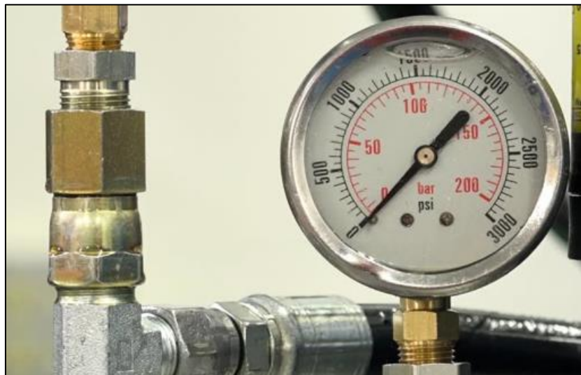
Figura 3. Manômetro de um sistema hidráulico
