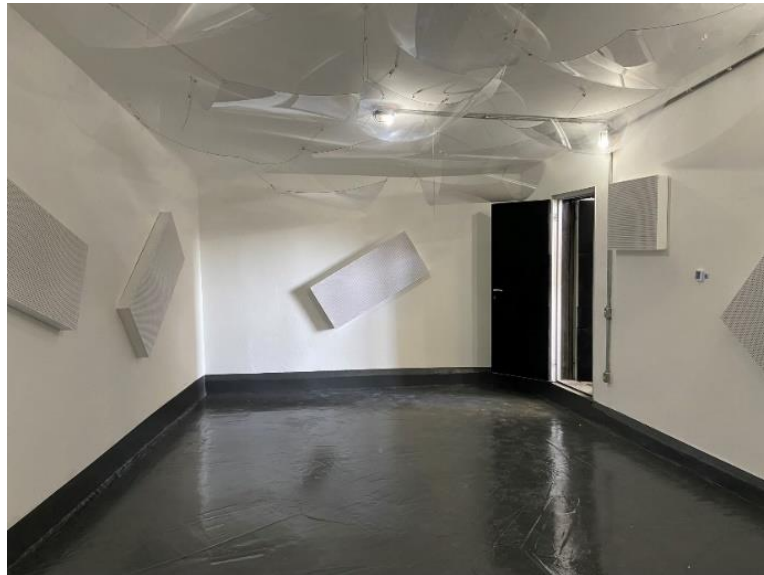
Figura 4: Absorvedores instalados nas paredes das câmaras.
