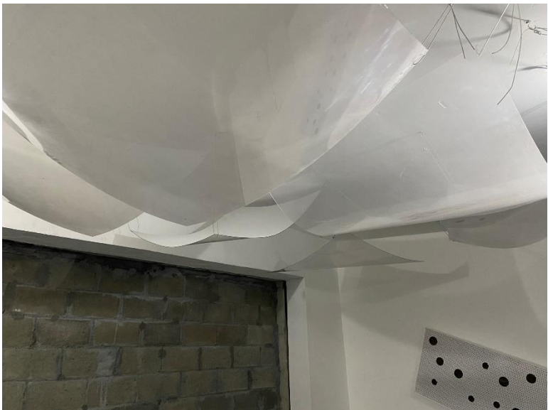
Figura 5: Difusores fixos, constituídos por painéis em policarbonato, dispostos no teto da câmara.
