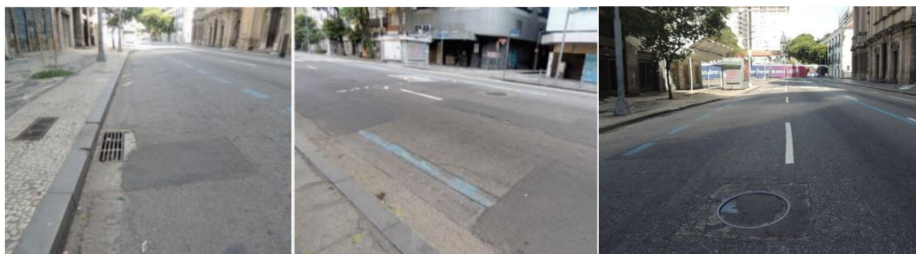
Figura 2: Irregularidades no pavimento asfáltico (Autor, 2022).
