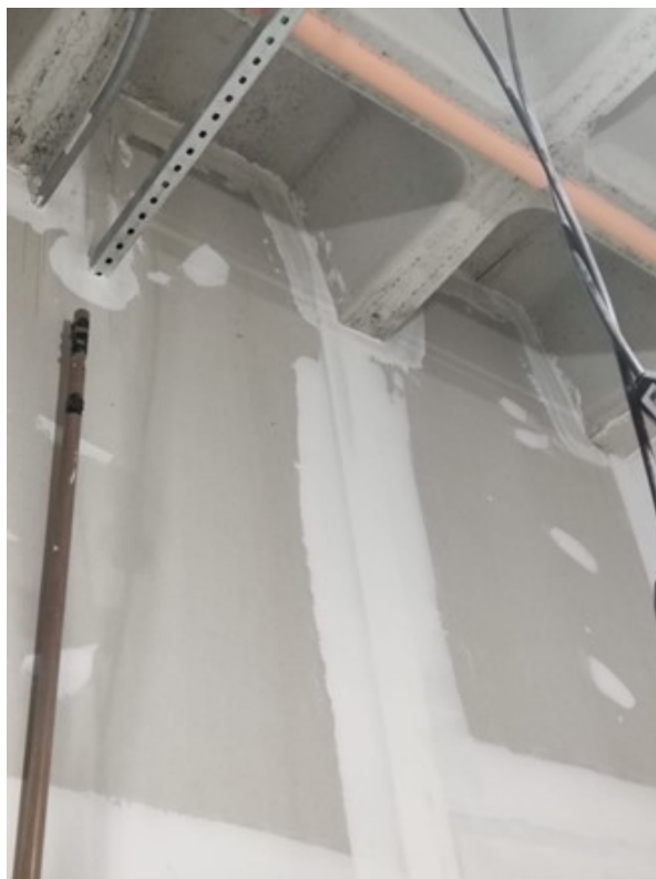
Figura 5: Vedação das paredes externas devido à característica da laje tipo cubeta.
