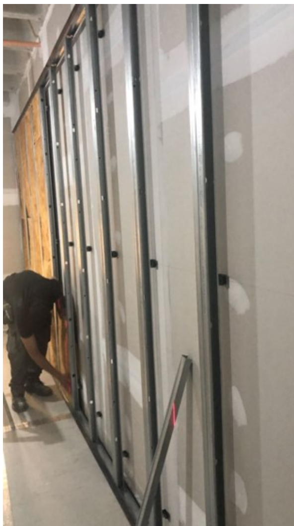
Figura 8: Damper instalado nas paredes internas.
