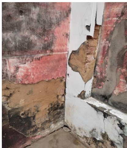
Figura 8: Deslocamento de reboco.
