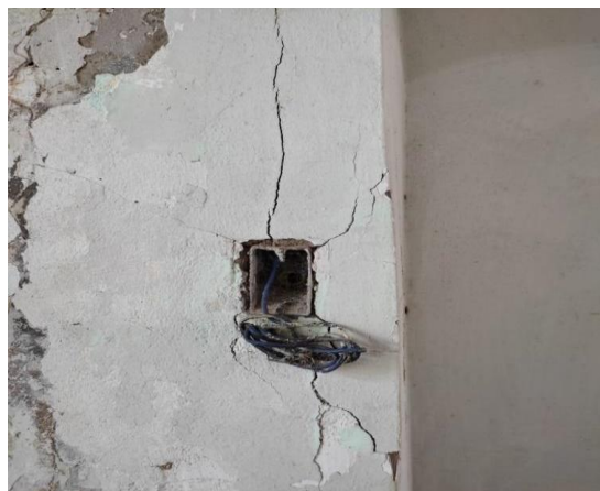
Figura 9: Fissuras e trincas no reboco.
