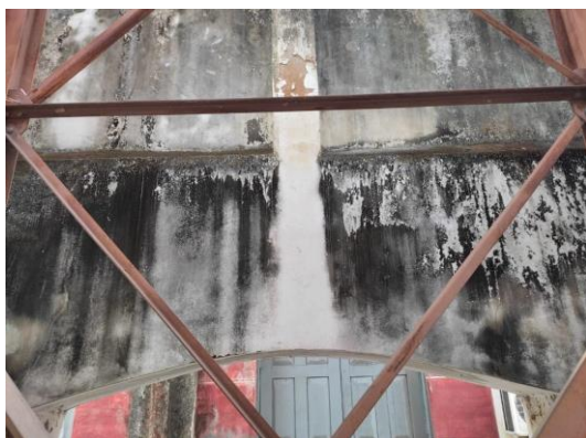
Figura 7: Patologia de eflorescência.
