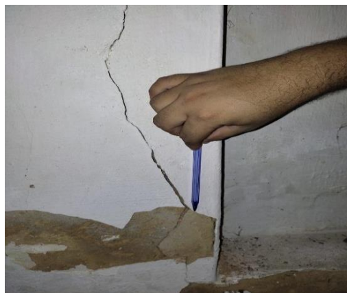
Figura 10: Trinca no reboco
