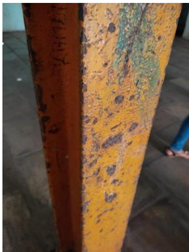
Figura 3: Estrutura metálica em processo de corrosão.
