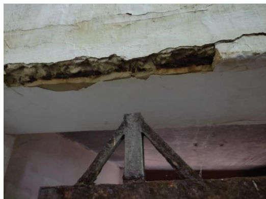
Figura 11: Viga com armadura exposta
