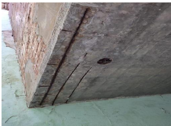
Figura 4: Corrosão da armadura de aço da laje.
