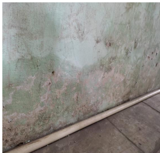
Figura 6: Umidade na alvenaria.
