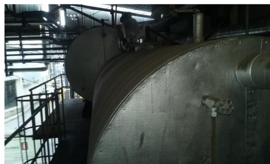
Figura 16. Tanques de condensado de processo, cuja água armazenada alimenta as bombas dinâmicas utilizadas na planta (Feghali, 2016).
