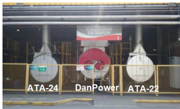
Figura 11. Vista frontal das caldeiras a gás natural (adaptado de Feghali, 2016).
