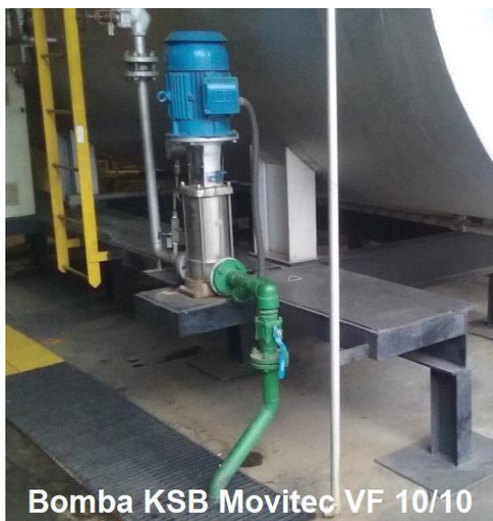
Figura 13. Bomba KSB Movitec VF 10/10, que alimenta a caldeira DanPower (adaptado de Feghali, 2016).
