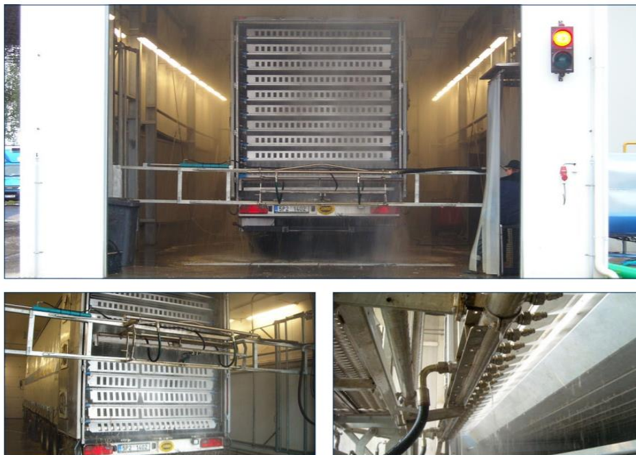
Figura 5: Equipamento utilizado para a lavagem automática dos trailers de transporte
