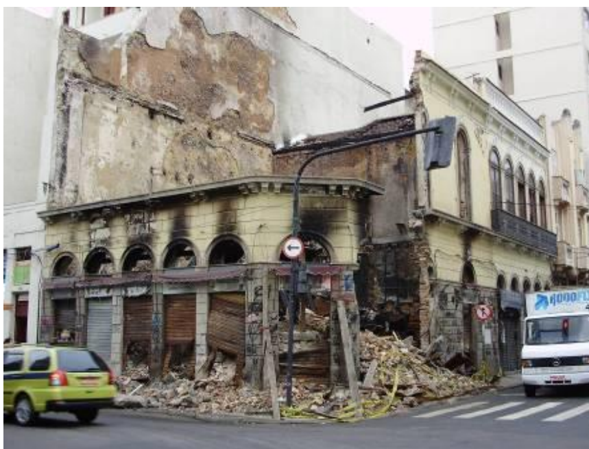
Figura 3. Ruínas resultantes de incêndio em sobrado localizado na Rua República do Líbano, esquina com Rua da Constituição. APAC do Corredor Cultural. Fonte: Autor, 2013
