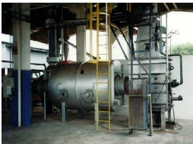
Figura 1 - Sistema GCC instalado na indústria de tintas WEG Química Ltda.
