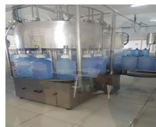
Figura 4: Máquina de enchimento de água.
