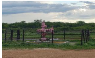
Figura 12: Poço de extração.
