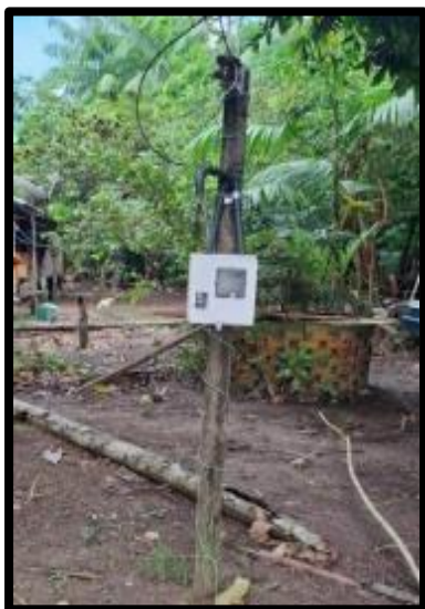
Figura 6: Contador de energia
