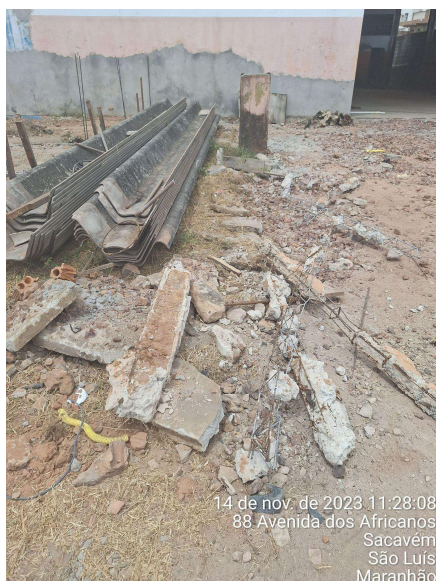
Figura 5. Armazenamento inadequado de telhas e resíduos diversos após demolição. Fonte: A autora (2026).
