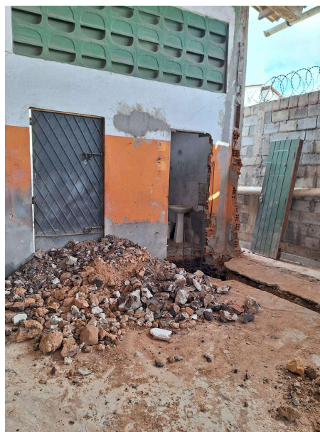
Figura 4. Entulho acumulado próximo à área de circulação interna da obra. Fonte: A autora (2026).
