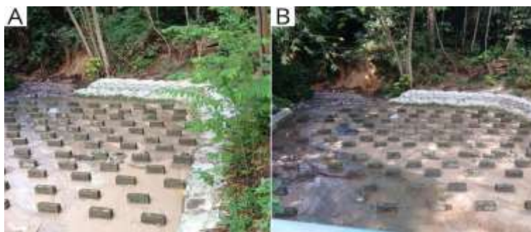
Figura 3 - Barragens de contenção
