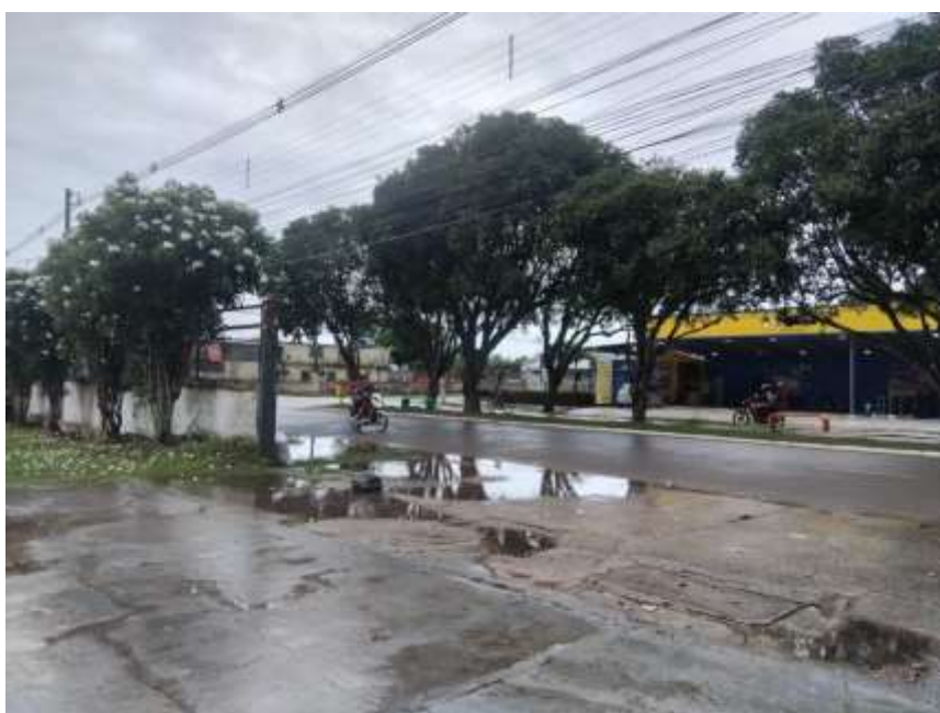
Figura 4 - Trecho próximo ao calçadão central após chuva.
