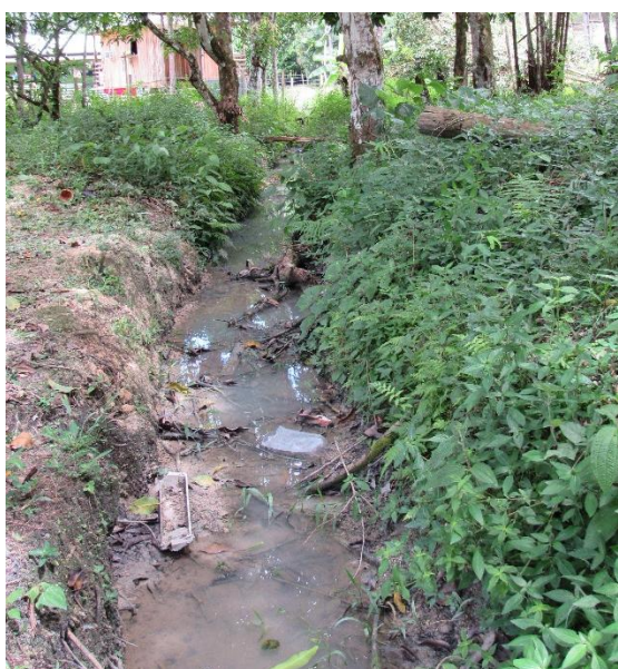
Figura 19. Vala de escoamento de águas pluviais.
