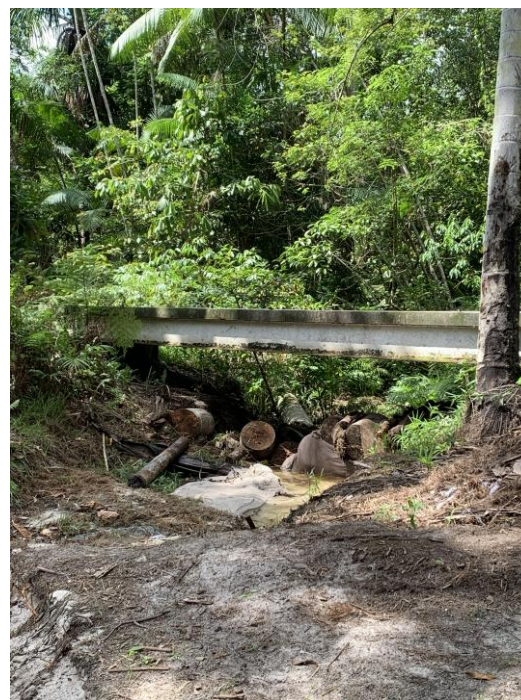
Figura 2. Trecho obstruído do igarapé do Mindu - Parque do Mindu.
