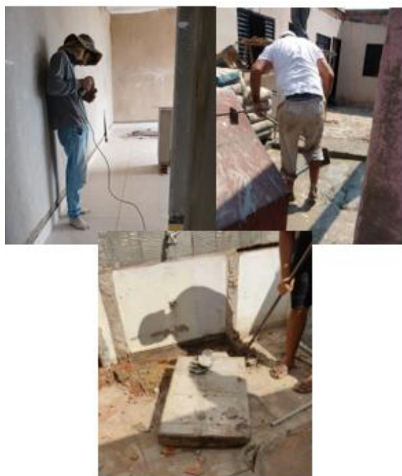
Figura 3: Ausência ou uso inadequado de EPIs em atividades com exposição direta ao risco.
