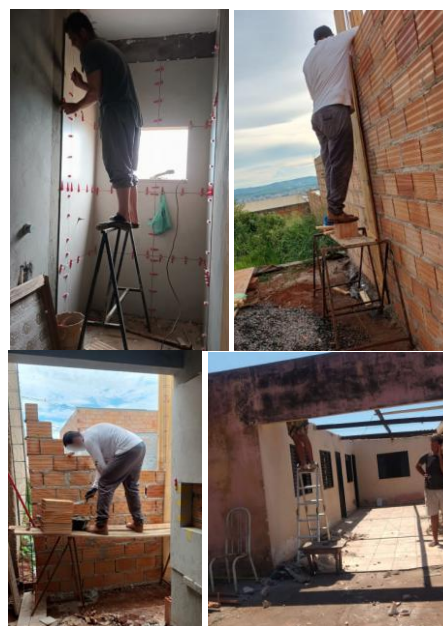
Figura 2: Improvisação de estruturas de apoio e exposição a riscos de queda
