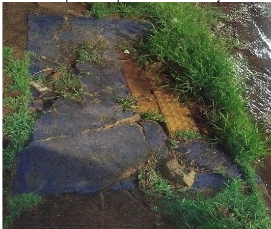
Figura 02 – Exemplo de barreira arquitetônica por falta de manutenção e descontinuidade de piso tátil.
