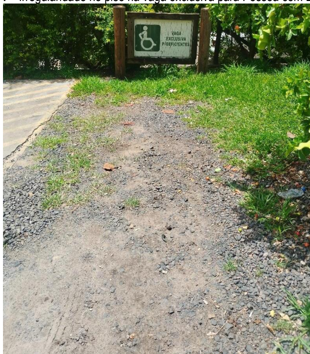
Figura 04 – Irregularidade no piso na vaga exclusiva para Pessoa com Deficiência
