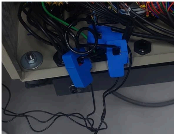
Figura 3. Sensores SCT-013, acoplados em cada fase de alimentação da máquina.
