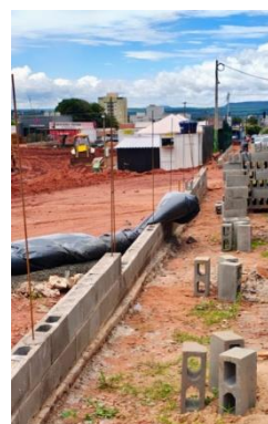
Figura 11. Materiais próximos à via pública sem sinalização - risco de atingir pedestres e causar acidentes.
