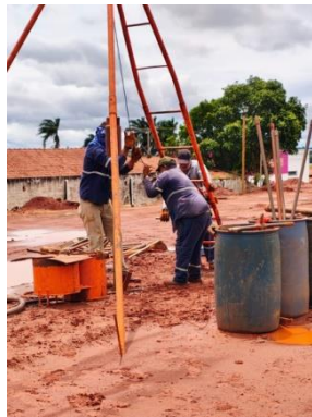
Figura 2. Sondagem do solo sem uso de EPI - níveis de ruído elevados, apresentando risco físico e de acidentes.
