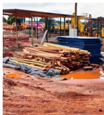
Figura 10. Armazenamento inadequado de materiais de carpintaria - sem sinalização, risco de acidentes.
