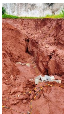
Figura 14. Muro de arrimo com risco de desmoronamento - risco de desmoronamento e sem sinalização, apresentando risco de soterramento (risco de acidente).
