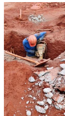
Figura 1. Uso de martelo sem proteção adequada - risco físico (ruído) e respiratório (químico).
