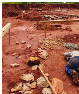
Figura 13. Descarte irregular de materiais - risco de acidentes.
