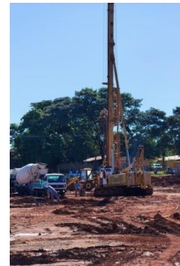
Figura 3. Tubulão (20x40) sem sinalização de segurança - risco de queda e contato com materiais perfurantes (risco de acidente).
