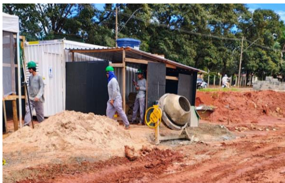
Figura 20. Depósito de cimento sem proteção respiratória - inalação de poeira e doenças respiratórias (risco químico).
