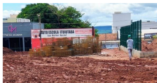
Figura 12. Armazenamento inadequado de ferragens - risco de cortes e perfurações (risco de acidente)
