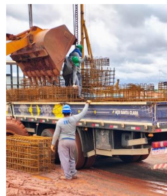
Figura 4. Trabalhador sob pá mecânica - risco grave de esmagamento (risco de acidente).
