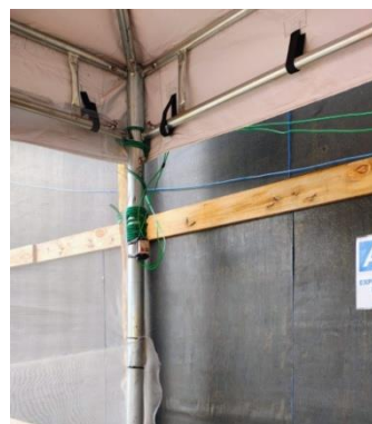
Figura 18. Disjuntor com fixação inadequada - risco de choque elétrico e incêndio.
