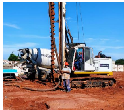
Figura 22. Ausência de EPI (proteção auditiva e solar) - caracterizando risco à saúde ocupacional devido à exposição ao ruído e radiação solar (risco físico).
