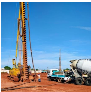
Figura 8. Área de perfuratriz sem sinalização - risco de tombamento e esmagamento (risco de acidente).
