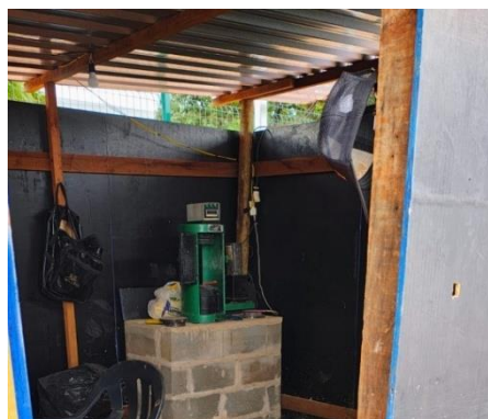
Figura 15. Instalação elétrica improvisada com emendas - risco de choque elétrico e incêndio (risco elétrico).
