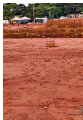
Figura 16. Instalação elétrica com emendas próxima a ferragens - risco de choque elétrico.
