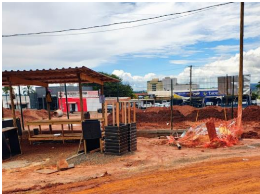
Figura 19. Carpintaria em local inadequado - uso de serra circular sem sinalização e sem uso adequado de EPIs, apresentando risco de acidentes, ruído e sobrecarga ergonômica (risco físico, ergonômico e de acidente).
