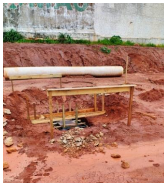
Figura 7. Sapata sem sinalização - risco de acidentes (risco de acidente).
