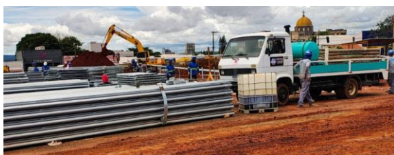
Figura 21. Armazenamento inadequado de combustível - risco de incêndio e explosão (risco químico e de acidente).
