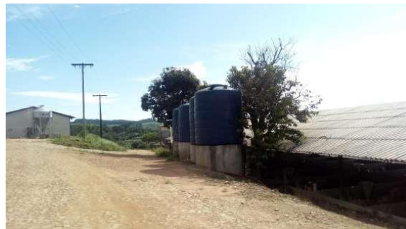
Figura 8. Caixa de fornecimento de água sem sombreamento adequado.
