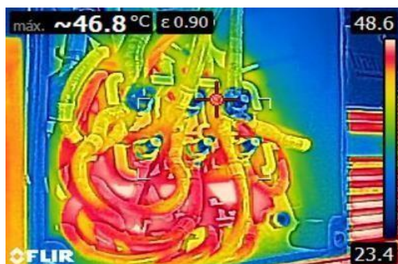
Figura 5. Termografia de um motor em manutenção.
