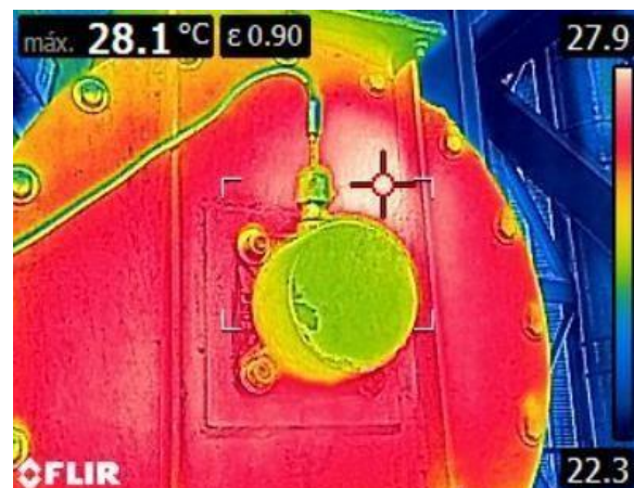
Figura 3. Termografia de mancal na planta de operação.
