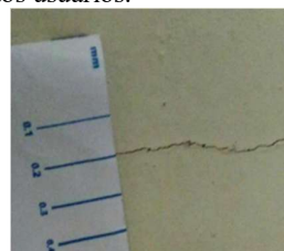
Figura 2. Representação das fissuras em revestimento argamassado.
