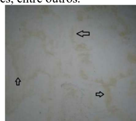
Figura 3. Representação de manchas/infiltrações. Fonte: Moreira, Costa e Barbosa (2021)
