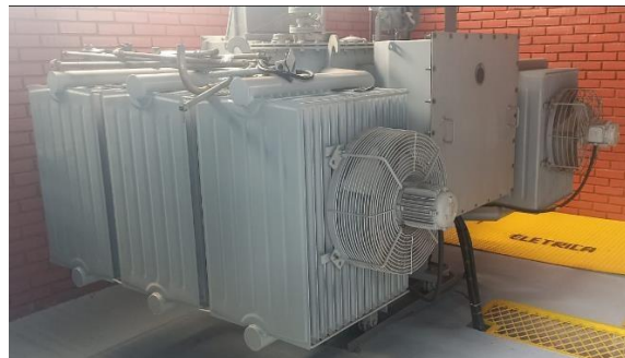
Figura 2. Transformador após a repotenciação.
