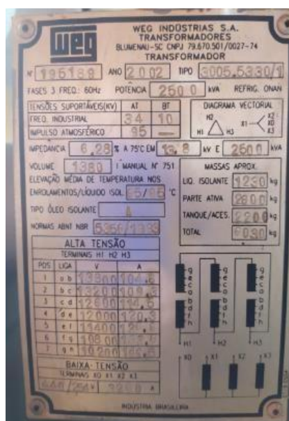
Figura 4. Foto da placa de identificação do transformador.
