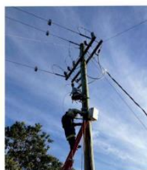
Figura 10. Equipamento instalado em campo
