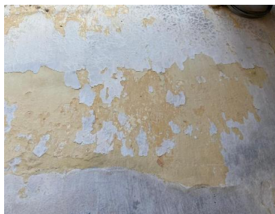
Descascamento da pintura. Fonte: os autores, 2026.
