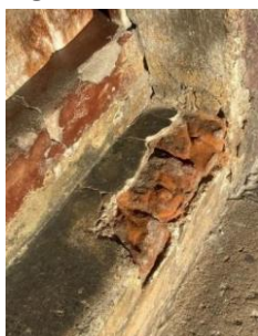
Degrau com alvenaria exposta e degradada. Fonte: os autores, 2026.
