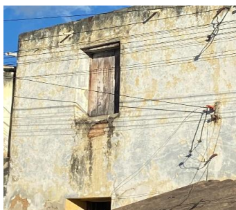
Descascamento da pintura. Fonte: os autores, 2026.
