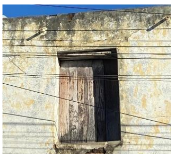
Ressecamento e perda de pintura da esquadria. Fonte: os autores, 2026.
