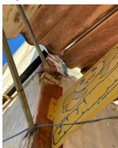
Barras engastadas na alvenaria exposta e degradada. Fonte: os autores, 2026.
