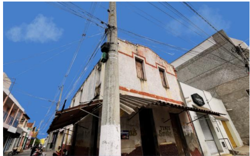
Registro fotográfico para identificação de patologias e aplicação do Método GUT. Fonte: os autores, 2026.
