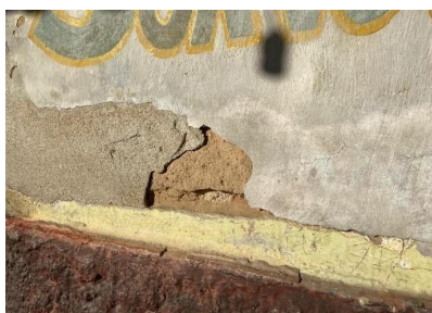
Camadas de revestimento faltantes revelando o reboco. Fonte: os autores, 2026.
