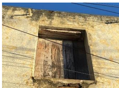
Ressecamento e perda de pintura da esquadria. Fonte: os autores, 2026.
