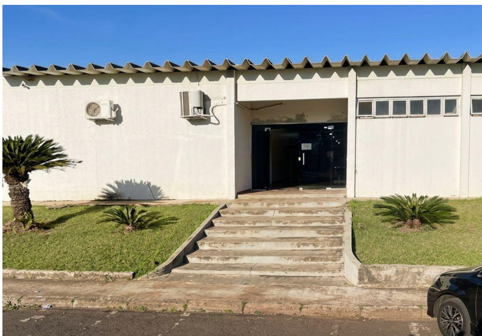
lateral da prefeitura apenas com escada e sem corrimão
