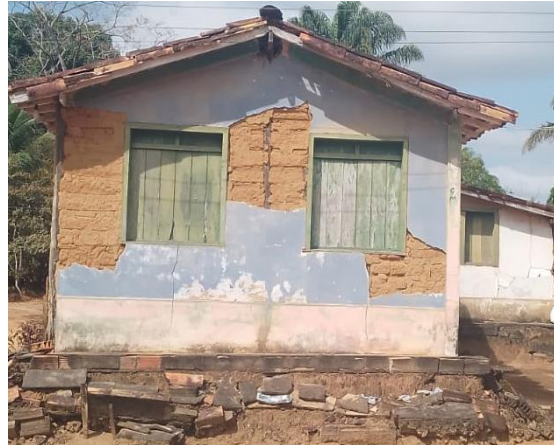
Casa de pau a pique onde o reboco caiu Fonte autores, 2025
