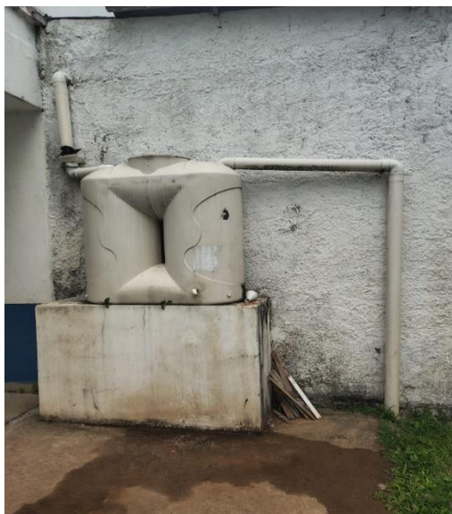
Figura 5 – Sistema de reaproveitamento de água da chuva e da condensação do ar-condicionado
