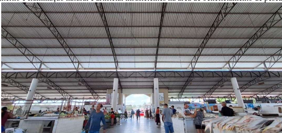
Figura 2 - Cobertura em zinco sem isolamento térmico, contribuindo para o desconforto térmico no ambiente interno e Iluminação natural e artificial insuficientes na área de beneficiamento de pescado
