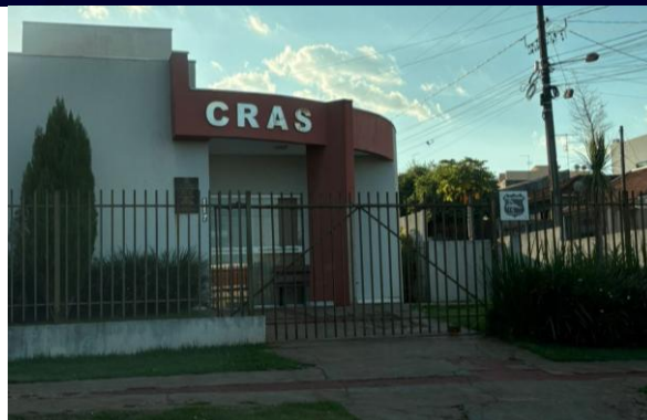
Figura 10- CRAS: Falta de sinalização de vagas para PcD na área externa. Fonte: Galeria pessoal (2026)
