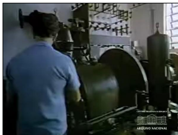
Figura 3. Sala do Gerador da antiga usina Fonte: Arquivo Nacional, 1977.
