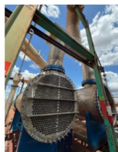
Figura 1. Trocador de calor casco e tubo instalado em uma unidade industrial.
