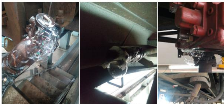
Figura 6. Registro fotográfico de avarias encontradas – Vazamentos de Ar no encanamento geral, secundários, conjunto de válvulas e timoneria/ajustador travado.
