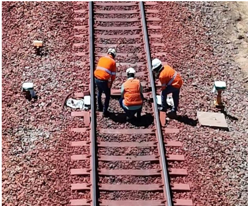
Figura 4. Inspeção técnica em aparelhos Hot box
