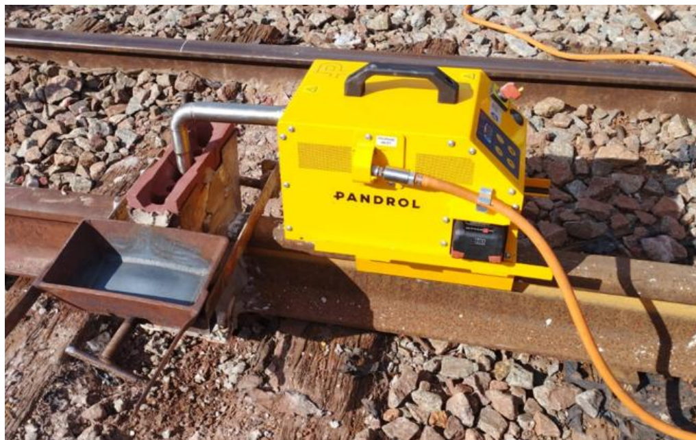
Figura 3. Pré-Aquecedor de Alta Vazão - HFP
