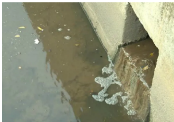
Figura 8: Esgoto sendo despejado no Canal da Costa.
