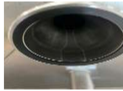
Figura 04 – Foto da placa de fluxo após limpeza
