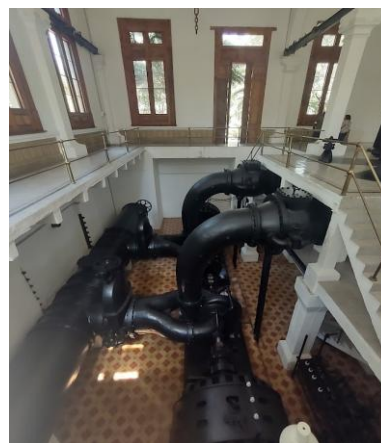
Imagen10. Equipo de bombeo. LGS.
